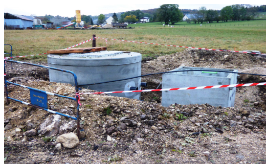
Poste de refoulement et chambre à vannes
